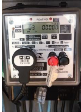
FIGURA 6 – MEDIDOR DE ENERGIA BIDIRECIONAL
