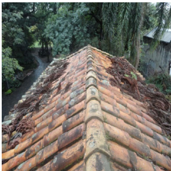
FIGURA 13 – EFEITO DE FUNGOS E PLANTAS CRESCENDO EM EDIFICAÇÃO
