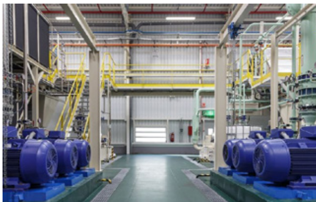
FIGURA 2 – SALA DE BOMBAS DE REFRIGERAÇÃO EM UMA ESTAÇÃO DE FILTRAGEM INDUSTRIAL DE UMA USINA
