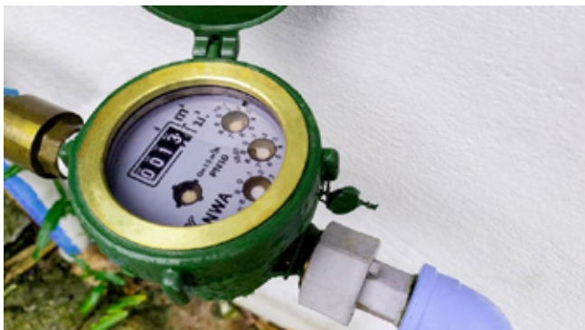
FIGURA 21 – MEDIDOR DE ÁGUA CONSUMIDA
