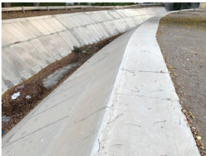
FIGURA 30 – SISTEMA DE DRENAGEM DE ÁGUA PLUVIAIS DE SEÇÃO TRAPEZOIDAL
