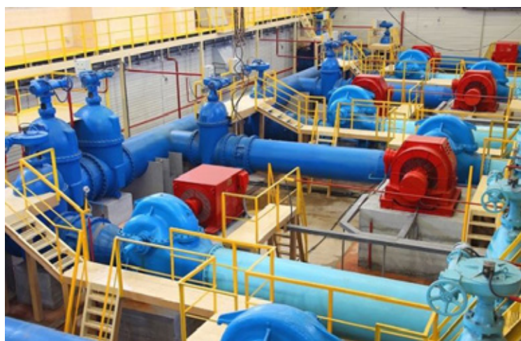
FIGURA 3 – ESTAÇÃO DE BOMBEAMENTO DE ÁGUA, INTERIOR INDUSTRIAL E TUBOS
