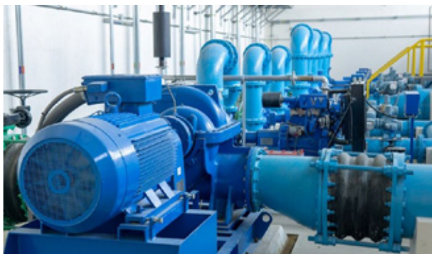
FIGURA 1 – ESTAÇÃO DE BOMBEAMENTO DE ÁGUA E ENCANAMENTO
