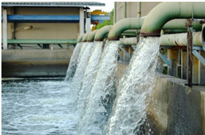
FIGURA 1 – SISTEMA DE ABASTECIMENTO DE ÁGUA
