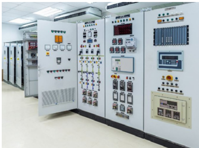
FIGURA 5 – PAINEL DE INTERRUPTORES ELÉTRICOS INDUSTRIAIS NA SUBESTAÇÃO DA USINA
