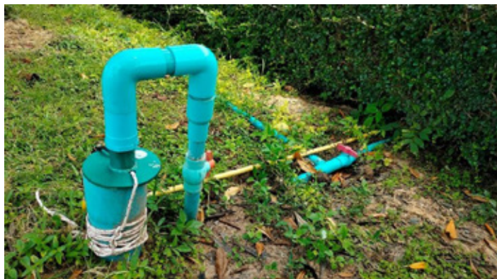
FIGURA 3 – POÇO DE ÁGUA SUBTERRÂNEA COM TUBOS DE PVC
